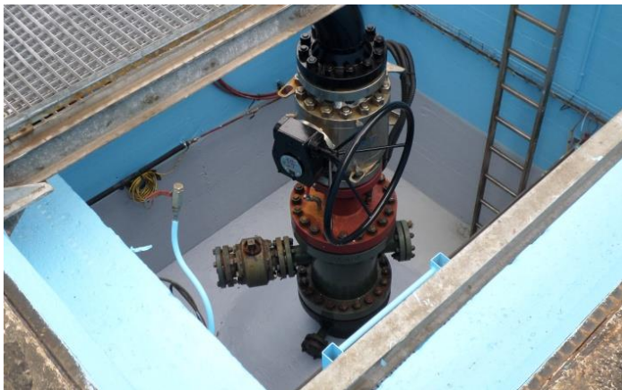
Figure 8. Tête de puits de production à la centrale de Chevilly-Larue (photo R. Mahéault).
