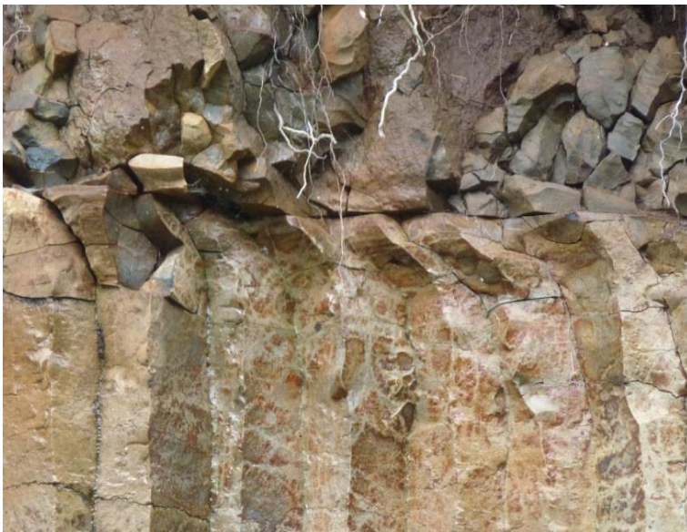
Figure 16. Saint-Arcons d'Allier (Allier). L'entablement de faux prismes, à l'occasion d'un séisme, s'est légèrement déplacé en courbant le sommet de la zone de colonnades.
